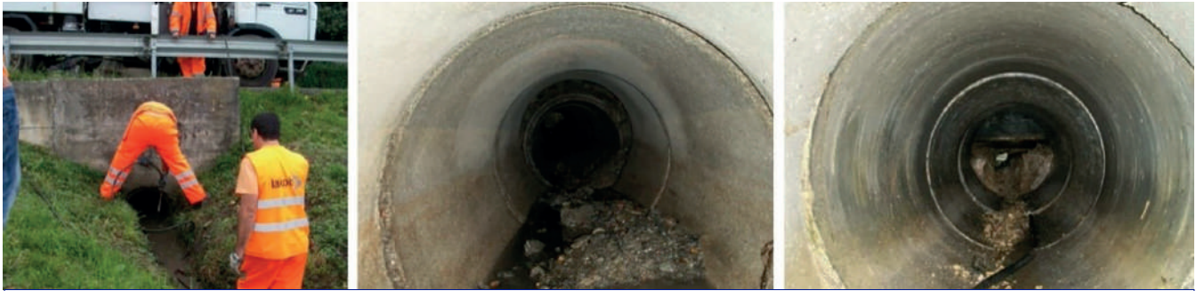
Figura 1. Tareas de inspección y mantenimiento correctivo en un colector de un tramo de carretera de Bizkaia, tras un episodio de lluvias. La imagen derecha muestra el estado de bloqueo del colector
