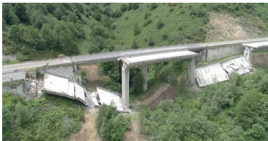
Figura 4. Estado final del viaducto de la calzada sentido A Coruña tras los colapsos del 7 y 16 de julio de 2022.
