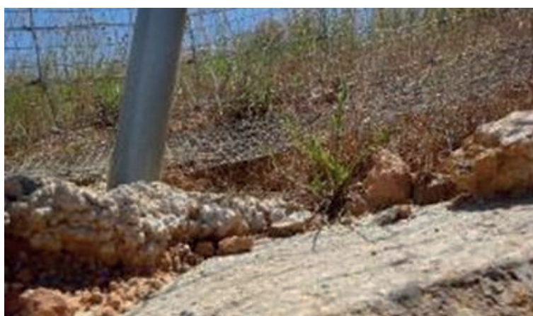
Figura 15. Los detalles o remates constructivos en las vallas de cerramiento deben cuidarse para evitar posibles puntos de intrusión de animales. Las auditorías de seguridad vial constituyen una buena herramienta para detectar estas deficiencias tanto en el proyecto como en la obra.
