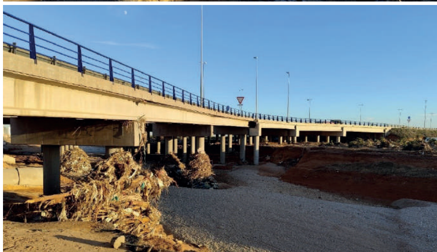
Desmoronamiento de varios tramos de la escollera de protección del talud de separación entre el Barranco del Poyo y la autovía A-3, a la altura de su p.k. 339+300 y erosión del lecho del Barranco del Poyo bajo la estructura de paso de la autovía A-7, a la altura de su p.k. 336+200, con socavación de los encepados de cimentación de las pilas del viaducto.
