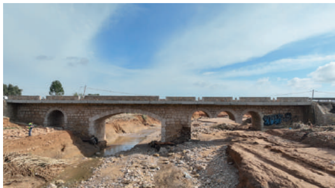
Daños en el puente de la carretera CV-416 sobre el barranco de Fuente-cica en Godella
