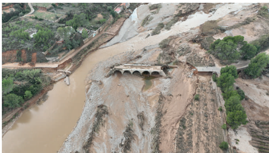
Afección a la carretera CV-422 pontón sobre el río Magro en Turis
