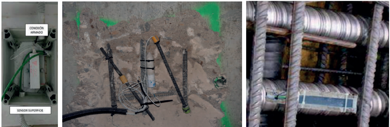
Figura 22. Sensorización de la corrosión en armaduras pasivas prehormigonado (izq.), posthormigonado (cent.) y de armaduras activas (der).
