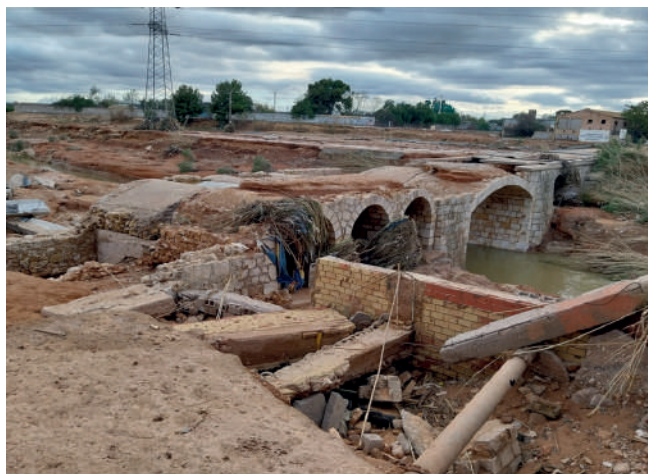
Daños en el puente de la carretera CV-413 sobre el barranco dels Cavalls en Aldaia
