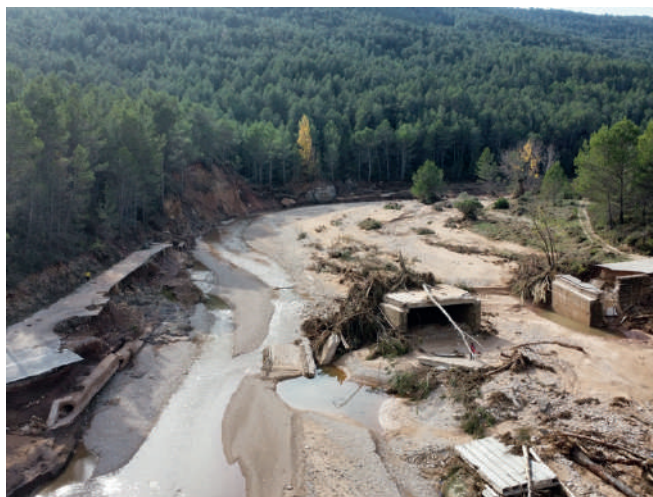
Afección a la carretera CV-429 puente sobre río Mijares en Yátova
