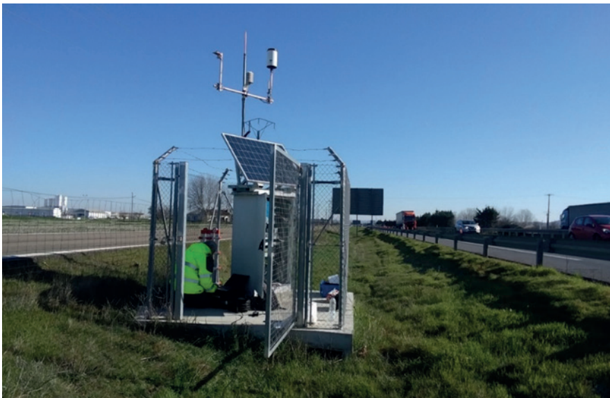
Figura 4. Estación de control de firmes A-62
