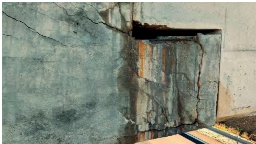
Figura 6. Detalle de las fisuras en el apoyo a media madera del voladizo en el vano 2 alzado oeste
