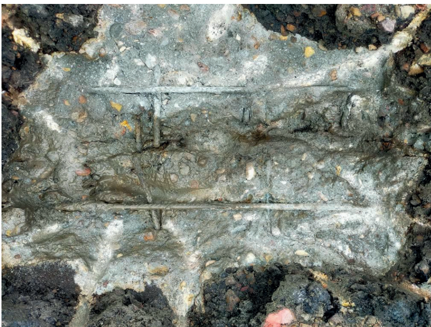
Figura 9. Detalle de las grietas longitudinales en cara superior del vano 1 y armaduras pasivas rotas
