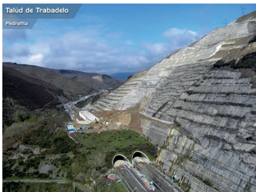
Figura 5. Talud de Trabadelo. Fotografía general del emplazamiento que aparece en la plataforma
