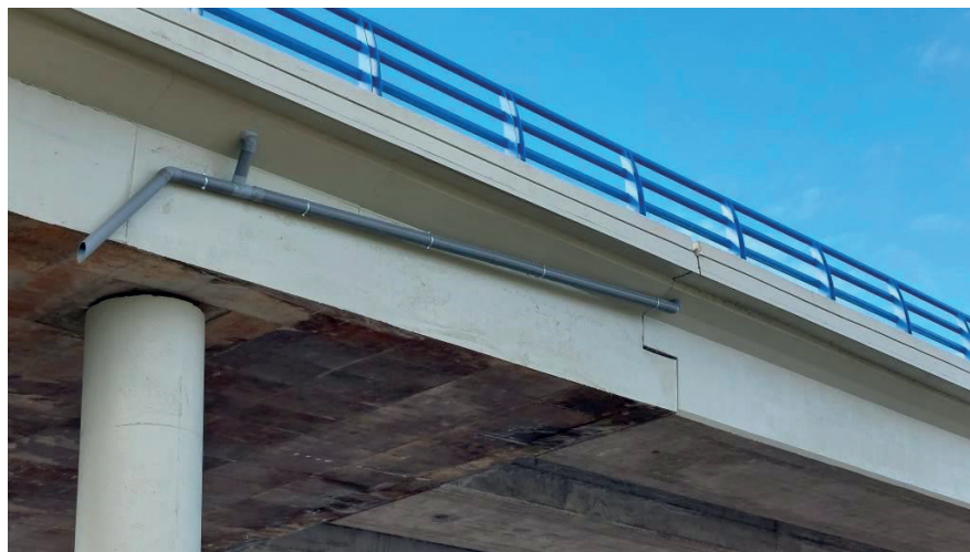
Figura 17. Salida del agua desde los sumideros
