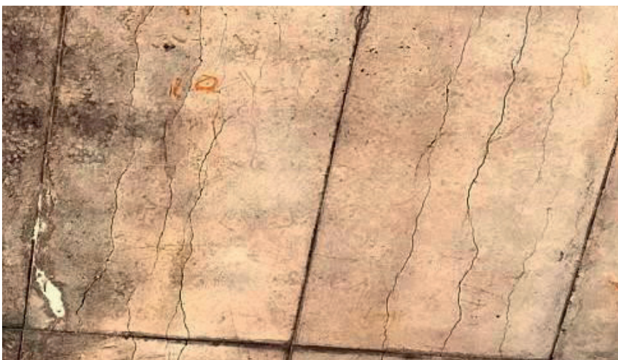
Figura 8. Detalle de las fisuras longitudinales en cara inferior del voladizo en el vano 2
